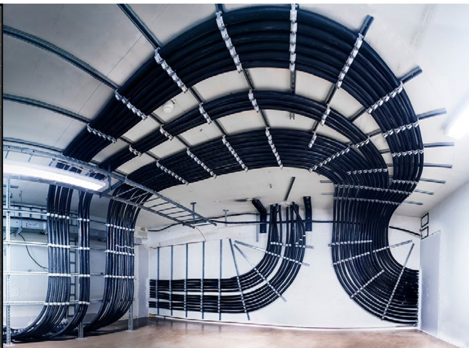
Systemet omfattar ett högspänningsnät på 11 kilovolt. Foto från vårt datacenter Thule.
